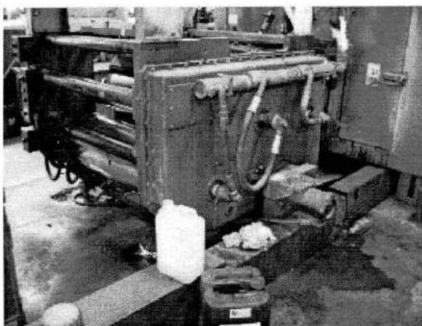
53- Unidade de resfriamento – lateral/vazamento
