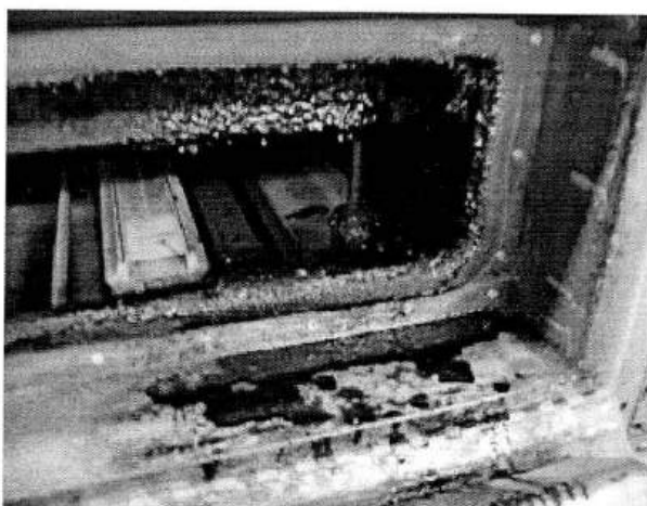
46- Unidade de secagem – bico de gás danificado
