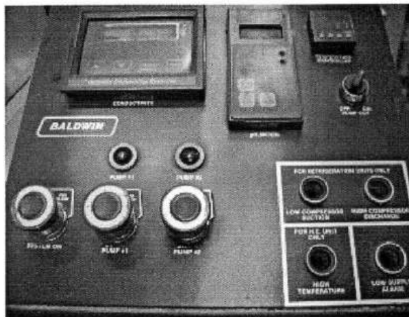
79- Painei de comando da unidade de resfriamento/circulação
