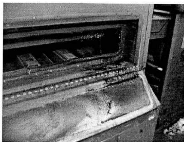
47- Unidade de secagem – bico de gás danificado
