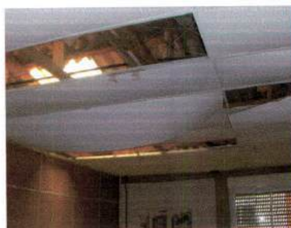
1 - FORRO E TELHADO DANIFICADOS
