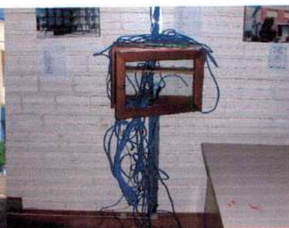
3 - INSTALAÇÃO ELÉ- TRICA DANIFICADA
